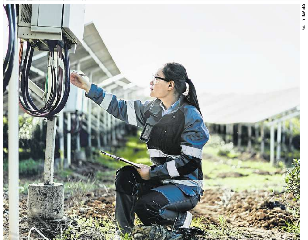
Je besser man sein Gebäude kennt, desto effizienter kann man es betreiben
