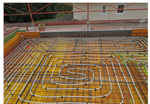
Dank der großflächigen Verteilung der Deckenheizung ist eine niedrige Vorlauftemperatur ausreichend.
